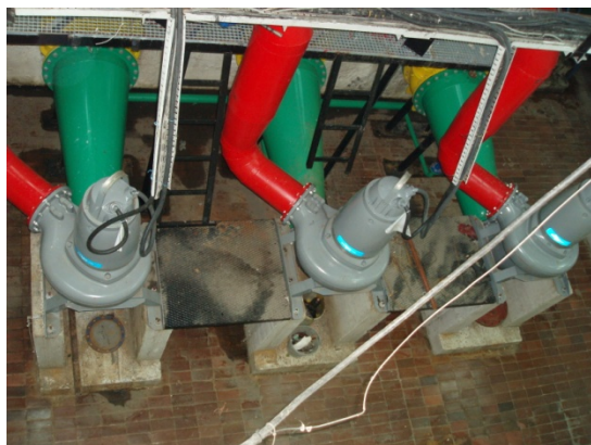
写真 2 雨水排水用ポンプ
